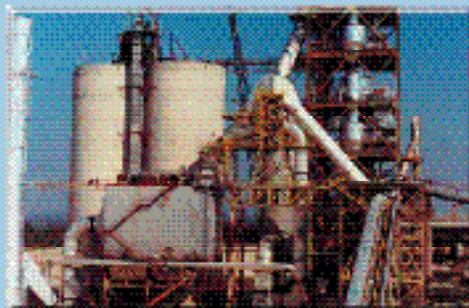
Система для перекачки и подъема товарного цемента
